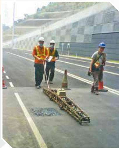
▲ 工務區域試驗所會安排地盤實地測試服務，包括土壤密度、馬路漆油的抗滑度和路面紋理深度及規律性等。
